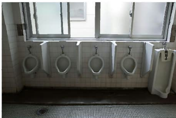
図 2-27 旧型の衛生器具（加治木庁舎）
