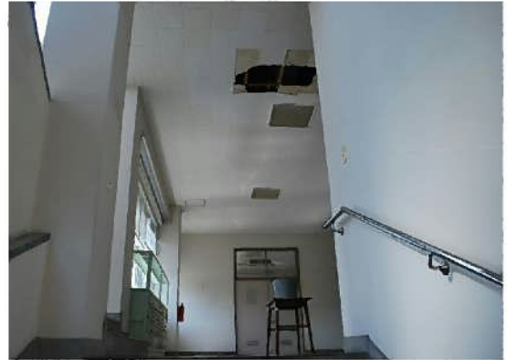
図 2-16 天井漏水跡（蒲生庁舎）
