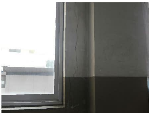
図 2-5 壁のひび割れ(加治木庁舎)
