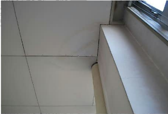
図 2-15 天井漏水跡（始良庁舎）
