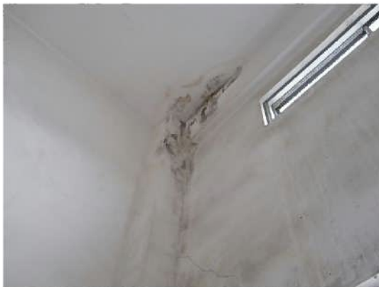
図 2-11 防水の劣化と躯体のひび割れ による漏水痕（加治木庁舎）
