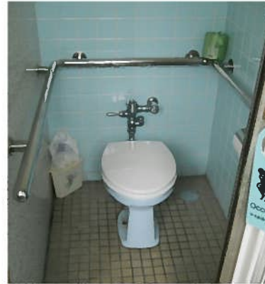
図 2-26 旧型の衛生器具（蒲生庁舎）
