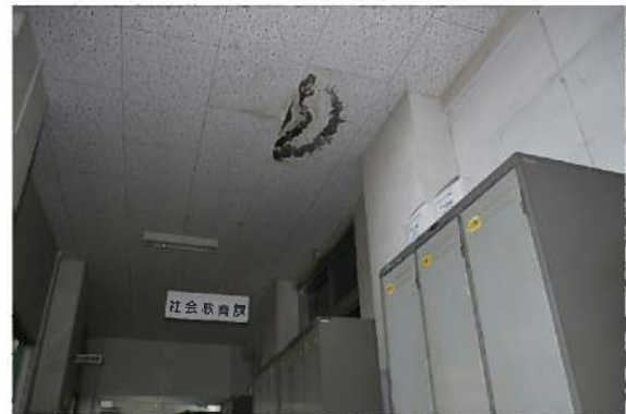
図 2-14 天井漏水跡（加治木庁舎）
