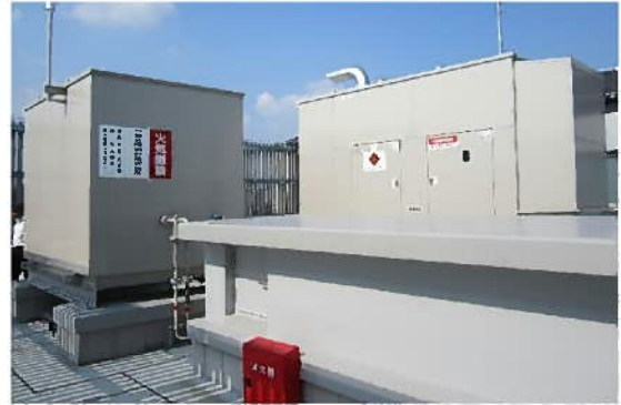
図 7-3 非常用発電設備の例
