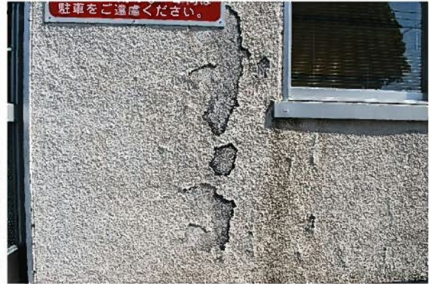
図 2-10 外装仕上げの剥離（蒲生庁舎）
