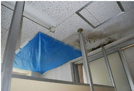
図 2-13 天井漏水跡（加治木庁舎）
