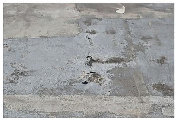
図 2-12 屋上防水の劣化（加治木庁舎）
