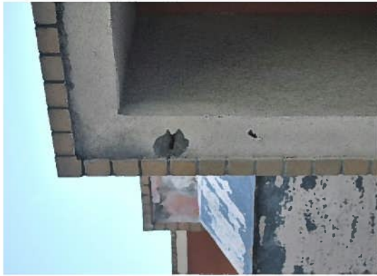
図 2-7 壁下端鉄筋の露出(始良庁舎)
