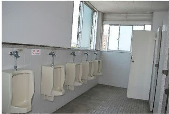
図 2-25 旧型の衛生器具（始良庁舎）
