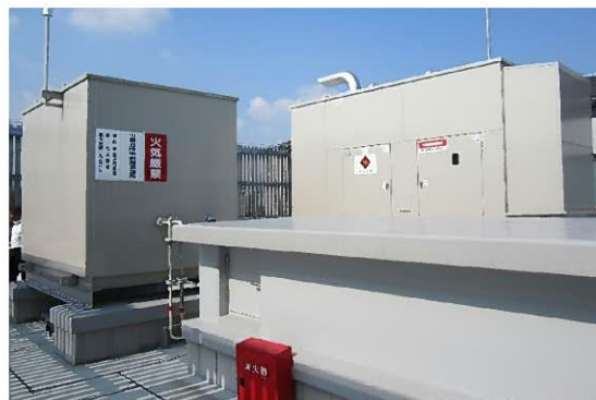
図11 非常用発電設備の例
