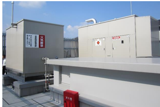
図 13 非常用発電設備の例
