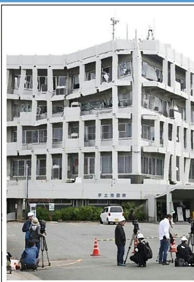
【写真】被災した宇土市庁舎 倒壊の恐れで立ち入りが禁止された
