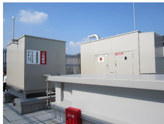
図7 非常用発電設備の例
