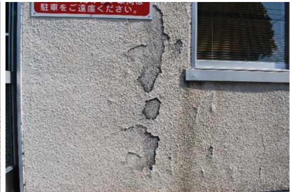
図 2-10 外装仕上げ材の剥離（蒲生庁舎）
