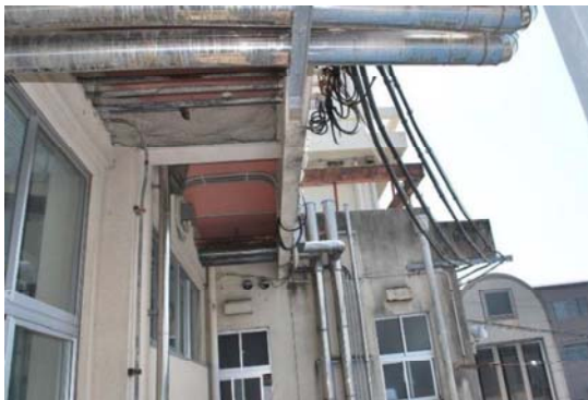
図 2-17 外壁に露出した配管（始良庁舎）
