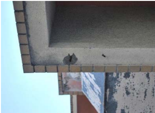
図 2-7 鉄筋の露出(始良庁舎)
