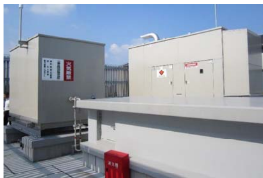
図 7-3 非常用発電設備の例
