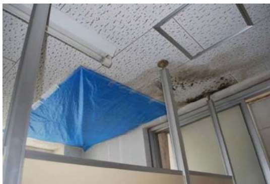
図 2-13 天井漏水跡（加治木庁舎）
