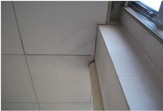
図 2-15 天井漏水跡（始良庁舎）
