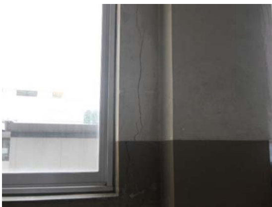
図 2-5 壁のひび割れ(加治木庁舎)
