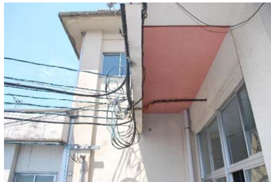
図 2-18 外壁に露出した配管（始良庁舎）
