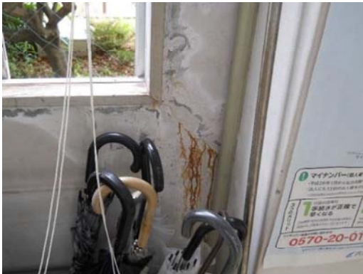
図 2-9 外壁のひび割れによる漏水痕（始良庁舎）
