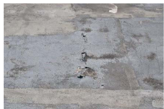
図 2-12 屋上防水層の劣化（加治木庁舎）
