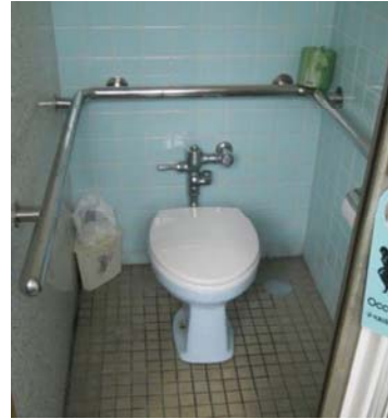
図 2-26 旧型の衛生器具（蒲生庁舎）
