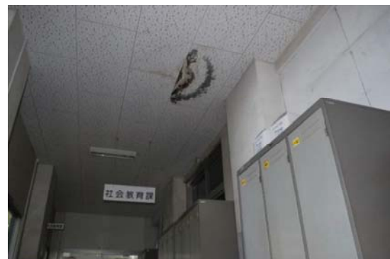
図 2-14 天井漏水跡（加治木庁舎）
