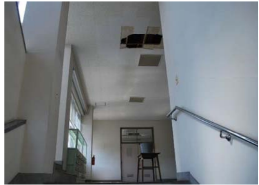
図 2-16 天井漏水跡（蒲生庁舎）
