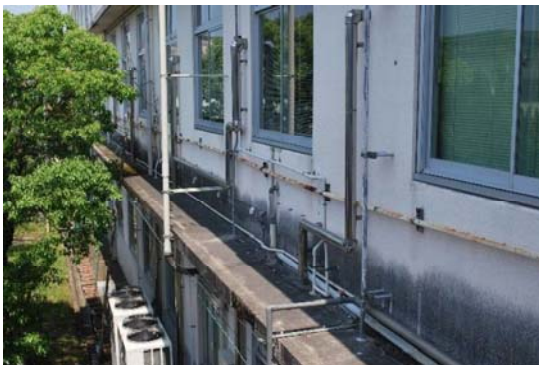
図 2-19 外壁に露出した配管（加治木庁舎）
