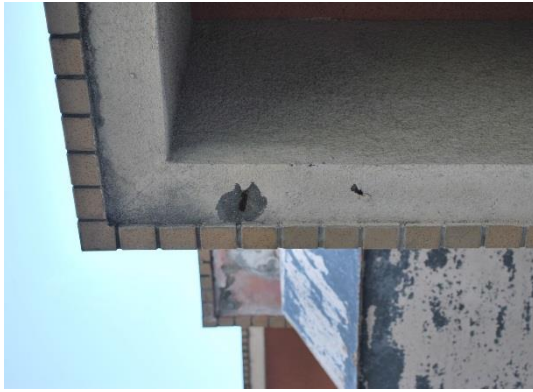
図 2-7 鉄筋の露出(始良庁舎)
