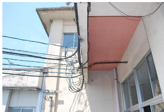
図 2-18 外壁に露出した配管（始良庁舎）
