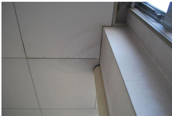
図 2-15 天井漏水跡（始良庁舎）
