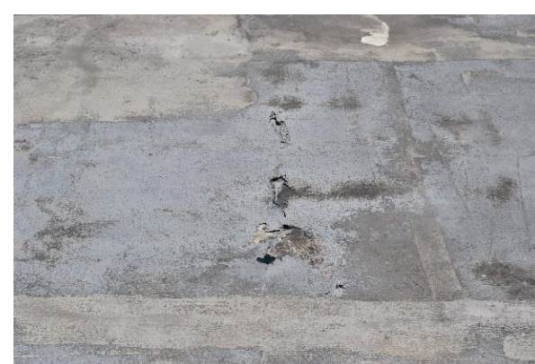
図 2-12 屋上防水の劣化（加治木庁舎）
