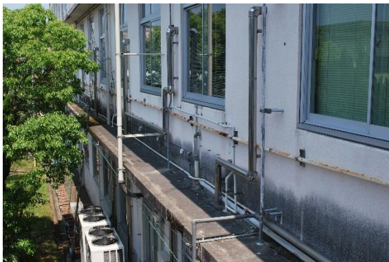
図 2-19 外壁に露出した配管（加治木庁舎）
