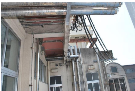
図 2-17 外壁に露出した配管（始良庁舎）
