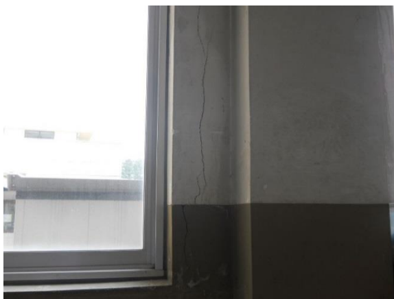
図 2-5 壁のひび割れ(加治木庁舎)
