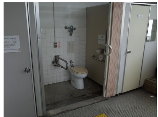
図 2-28 車椅子対応トイレ（加治木庁舎）
