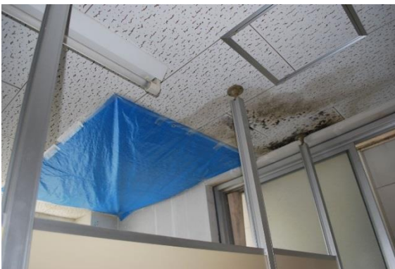
図 2-13 天井漏水跡（加治木庁舎）
