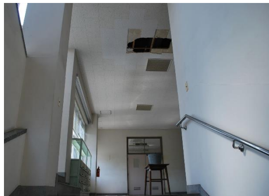
図 2-16 天井漏水跡（蒲生庁舎）
