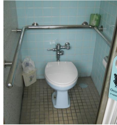
図 2-26 旧型の衛生器具（蒲生庁舎）
