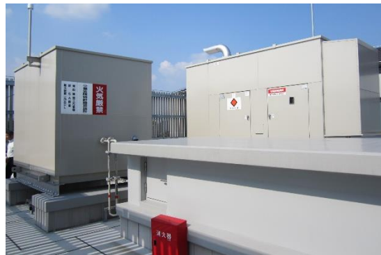
図 7-3 非常用発電設備の例
