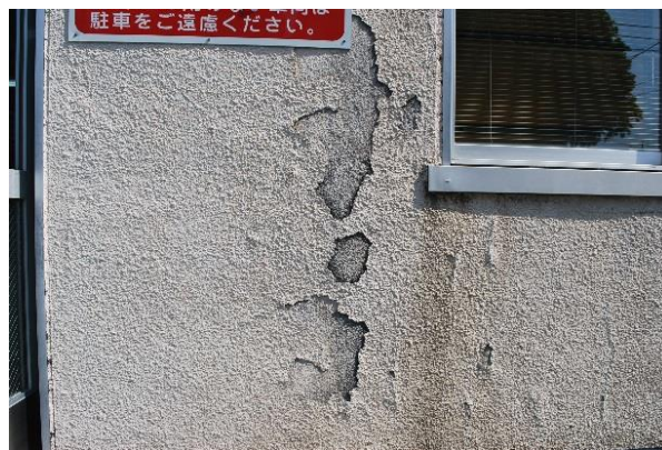
図 2-10 外装仕上の剥離（蒲生庁舎）
