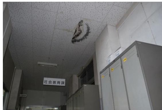
図 2-14 天井漏水跡（加治木庁舎）
