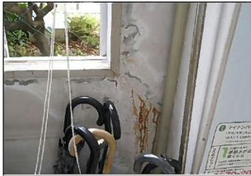
外壁のひび割れによる漏水痕 (始良庁舎)
