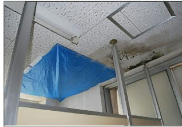
天井漏水痕（加治木庁舎）
