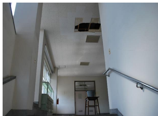
図 15 天井漏水跡（蒲生庁舎）
