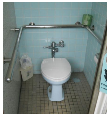
図 25 旧型の衛生器具（蒲生庁舎）
