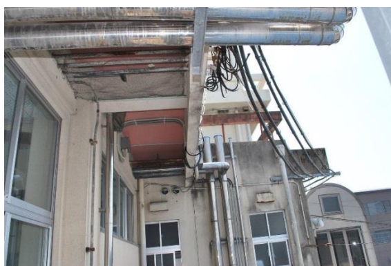
図 16 外壁に露出した配管（始良庁舎）
