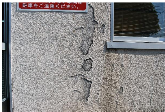
図9 外装仕上げの剥離(蒲生庁舎)
