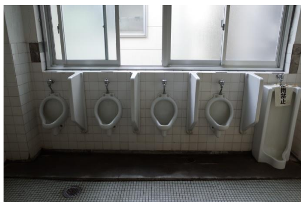
図 26 旧型の衛生器具（加治木庁舎）
