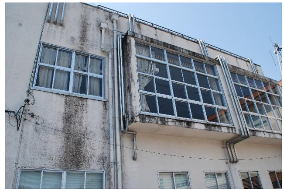
図 19 外壁に露出した配管（蒲生庁舎）
