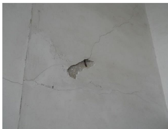
図5 壁のひび割れと鉄筋の露出(加治木庁舎)
