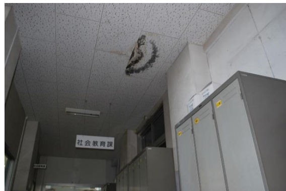
図 13 天井漏水跡（加治木庁舎）
