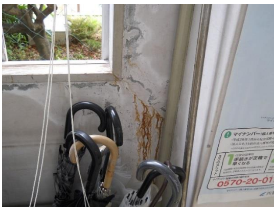
図8 外壁のひび割れによる漏水痕(始良庁舎)
