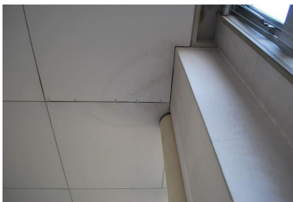
図 14 天井漏水跡（始良庁舎）
