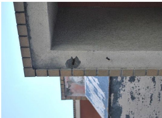
図6 壁下端鉄筋の露出(始良庁舎)
