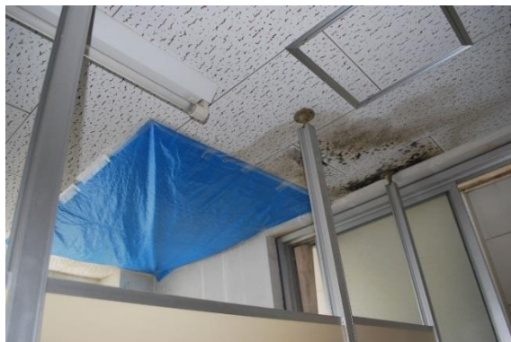
図 12 天井漏水跡（加治木庁舎）
