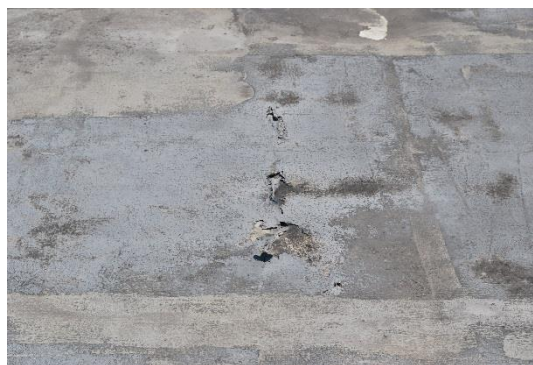
図11 屋上防水の劣化(加治木庁舎)
