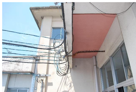
図 17 外壁に露出した配管（始良庁舎）
