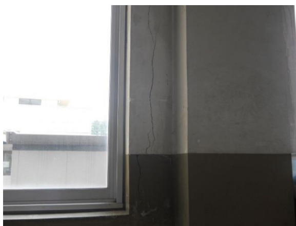
図4 壁のひび割れ(加治木庁舎)
