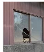
窓が割れた 管理不全空家
