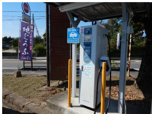
写真 電気自動車の充電設備（くすくす館）
