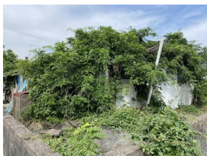
写真 雑草が繁茂した空き家
