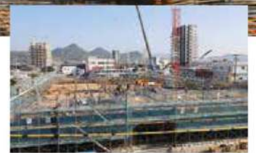
進む庁舎建設の進捗度は約50%。ちょうど折り返し地点(撮影は1月中旬)。
