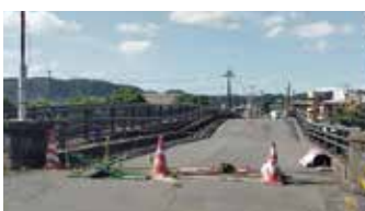
災害現場(錦江橋)
