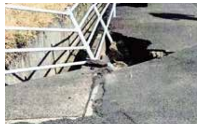
市道陥没による損害賠償の事例
