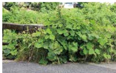
橋の欄干まで繁茂している雑草の様子
