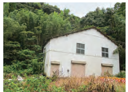
永原の市倉庫は屋根腐食の状態
