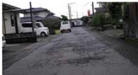
▲舗装が傷んでいる市道池島線
