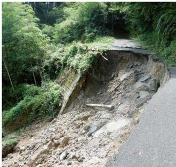
▲西浦地区のがけ崩れ現場
