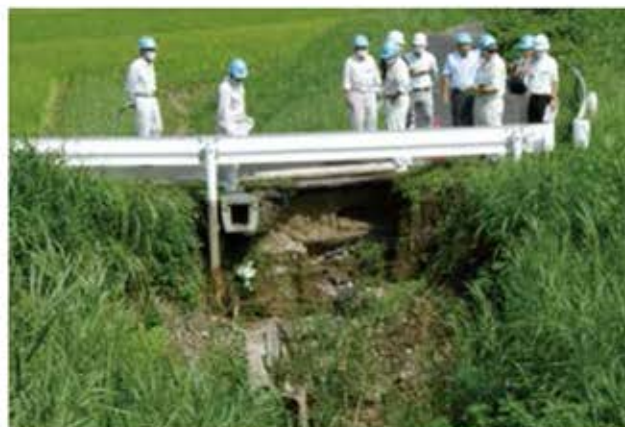
▲白男地区の農道災害現場
