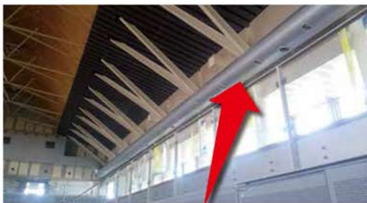
▲総合体育館に設置された空調装置配管
