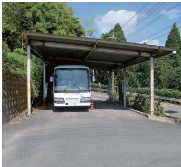
▲腐食がめだつスクールバス車庫
