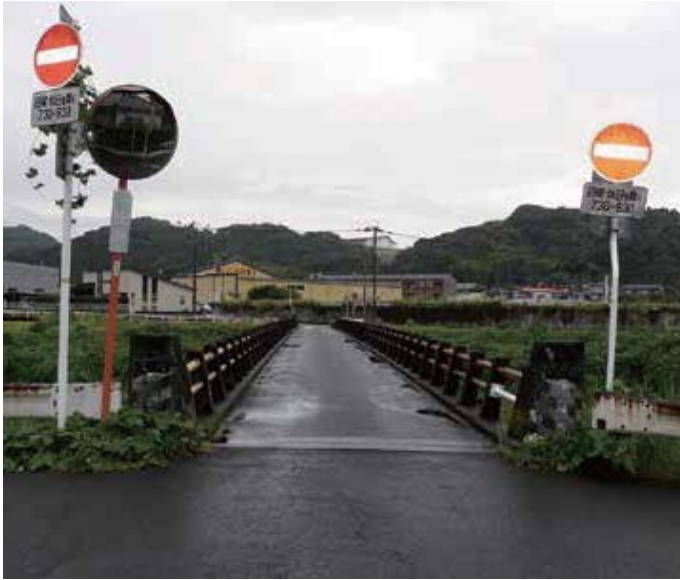
▲稲荷橋の拡幅改良を
