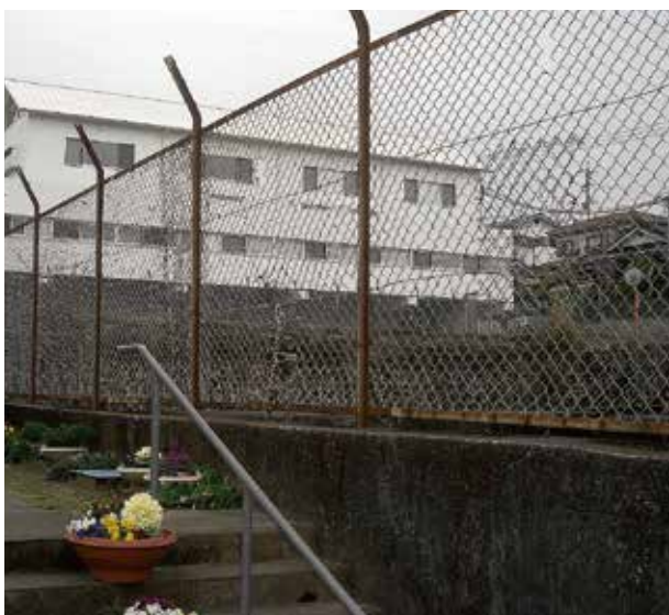
▲老朽化が見られる沈砂池のフェンス（始良ニュータウン）
