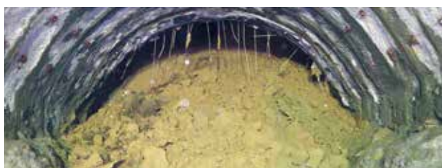
▲宇都トンネルの落盤の状況
