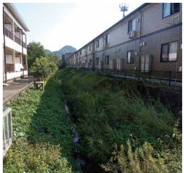
▲雑草が繁茂している排水溝
