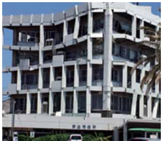
▲熊本地震により使用不能となった宇土市役所
