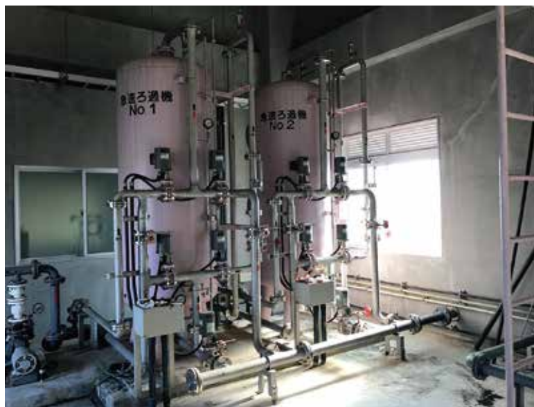
▲中野簡易水道ろ過機
