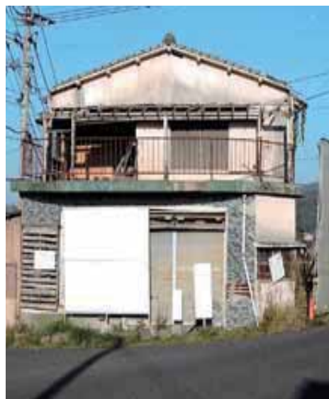
▲崩壊のおそれのある空き家
