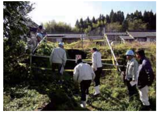
▲ 今回崩落した三大字の用排水路
