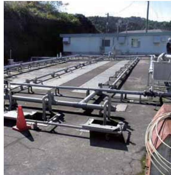
▲みさと台污水处理施設
