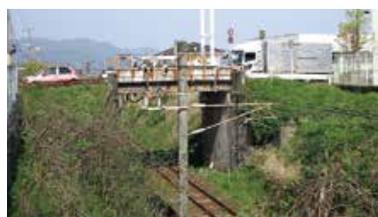
▲拡幅が待たれる木田橋
