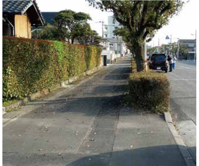
▲未整備の歩道
