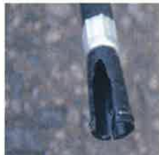
× ノズルの破損
