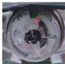
× 指示圧力計の損傷
