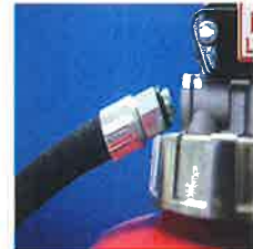
× 緊結ネジの破損 × ホースの脱落
