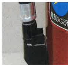
× 消火薬剤の漏れ
