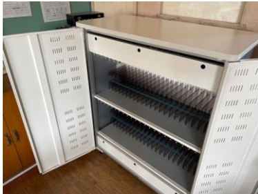
タブレットを保管する 電源キャビネット
