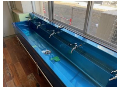
1号館に新設された手洗い場
