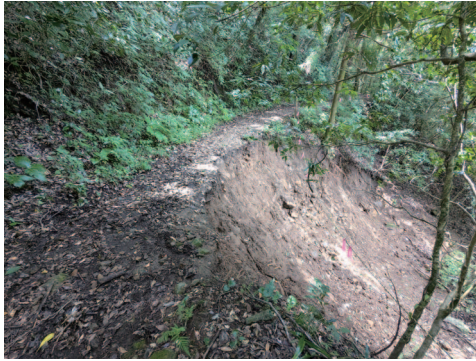
⑨路肩崩壊
