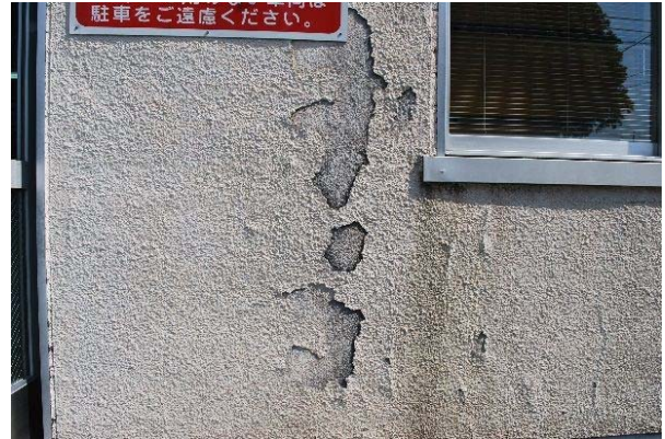
図 2-10 外装仕上げの剥離（蒲生庁舎）
