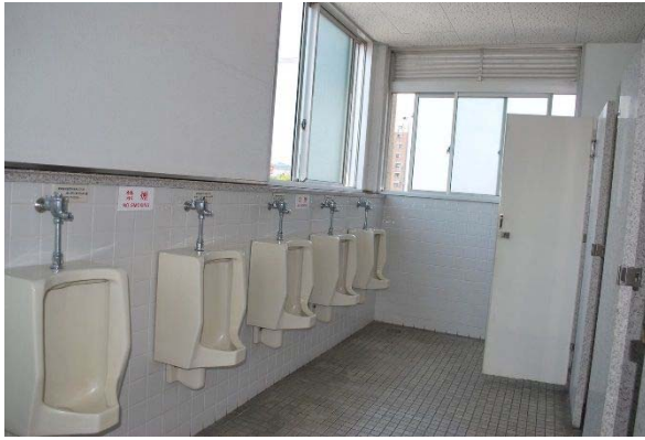
図 2-25 旧型の衛生器具（始良庁舎）
