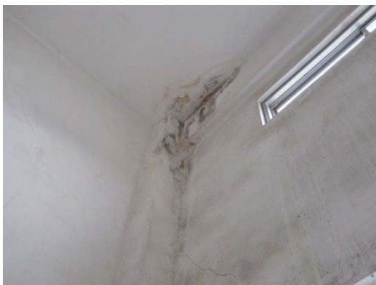
図 2-11 防水の劣化と躯体のひび割れ による漏水痕（加治木庁舎）
