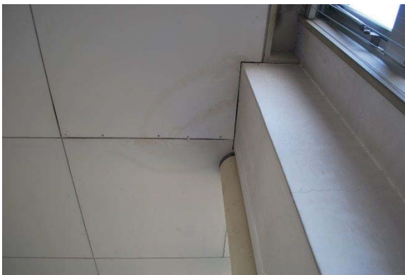
図 2-15 天井漏水跡（始良庁舎）
