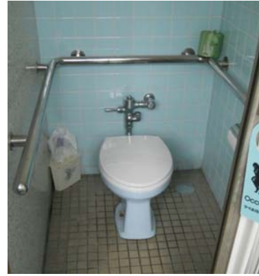
図 2-26 旧型の衛生器具（蒲生庁舎）
