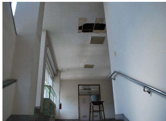
図 2-16 天井漏水跡（蒲生庁舎）
