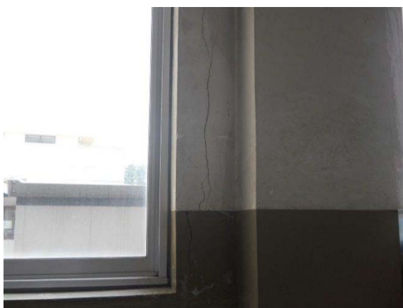
図 2-5 壁のひび割れ(加治木庁舎)
