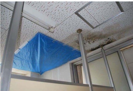
図 2-13 天井漏水跡（加治木庁舎）
