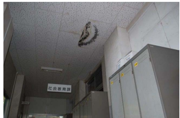
図 2-14 天井漏水跡（加治木庁舎）
