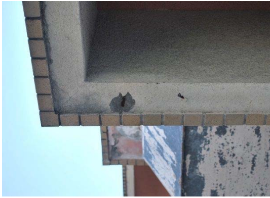
図 2-7 壁下端鉄筋の露出(始良庁舎)
