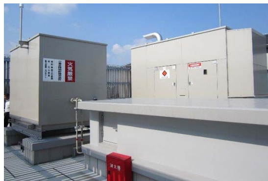
図 7-3 非常用発電設備の例
