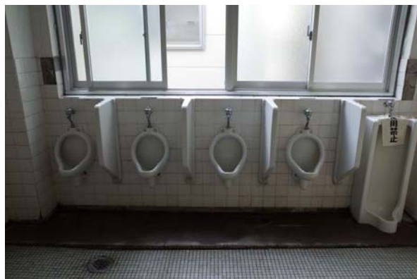
図 2-27 旧型の衛生器具（加治木庁舎）
