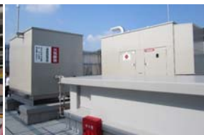
非常用発電設備のイメージ
