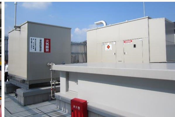
非常用発電設備のイメージ
