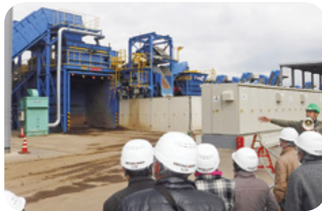
【混合廃棄物の選別を行う大型設備】
