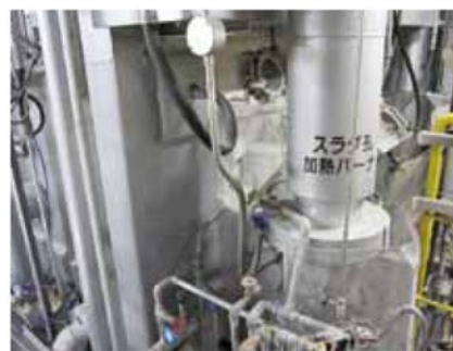
●灰溶融炉 灰を1400℃の高温で溶かしてスラグ化して、リサイクルしやすくします。
