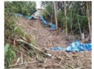
市道中野線の災害状況
