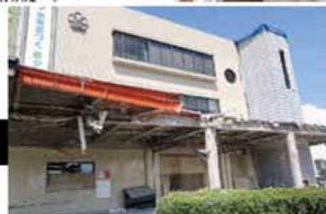
損壊した庁舎。被災した昨年4月に撮影(益城町資料)
