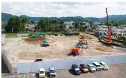
基礎工事の準備を進める加治木複合新庁舎現場。 令和5年7月28日撮影
