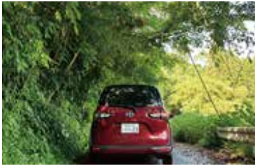
危険木が頭上に迫る県道の状況
