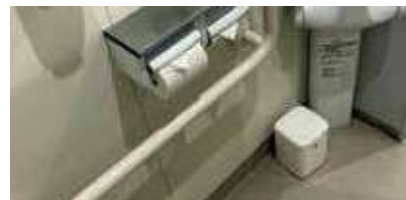
男子トイレにサンタリーボックスが設置されている始良公民館
