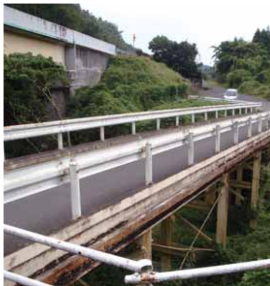
▲老朽化した池田下橋
