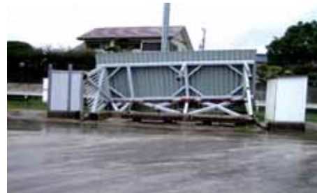
▲倒壊した加治木運動場ベンチ
