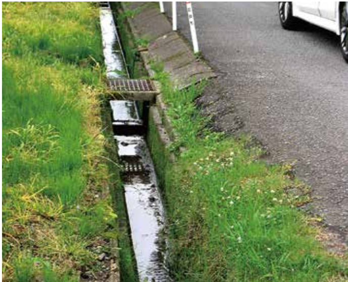
▲整備の必要な弓道場横の側溝
