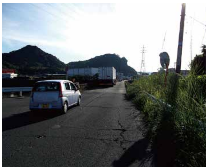
▲老朽化している始良橋
