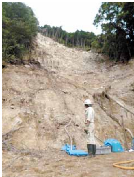
▲大雨で山腹崩壊した災害現場（平松地区）
