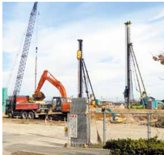
▲地元業者による建設が始まった 松原なぎさ小学校新築工事
