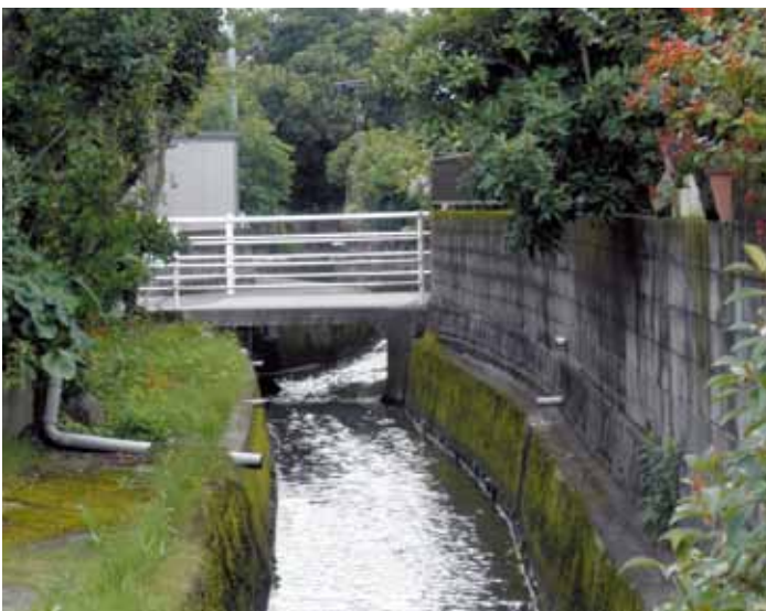
▲スマートIC設置より難しい雨水排水対策
