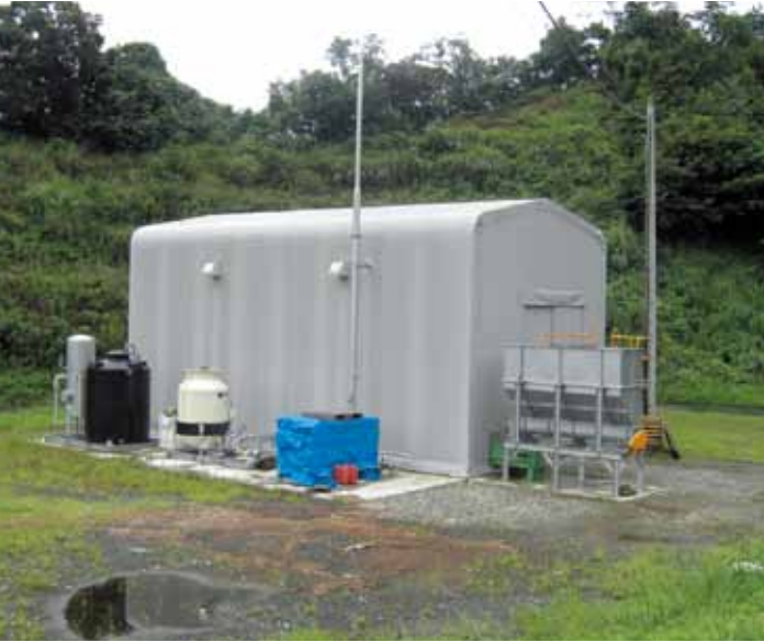
▲バイオ液体燃料の実証プラント（目木金地区）
