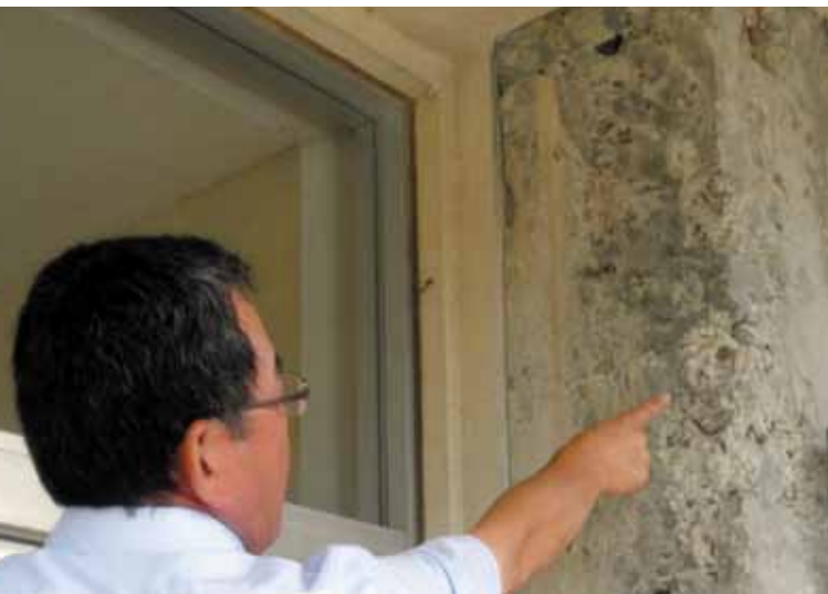
▲劣化が発見された三船小学校舎
