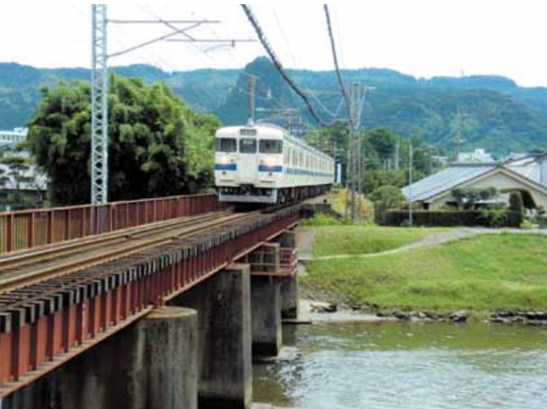
▲騒音不満が出ている網掛川鉄橋
